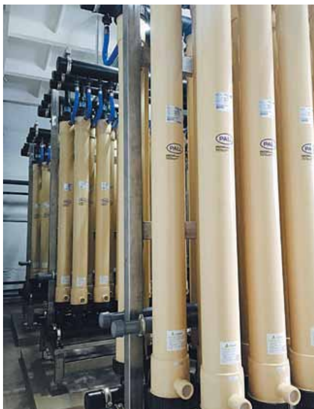
Система очистки сточной воды Pall Aria Multirack
